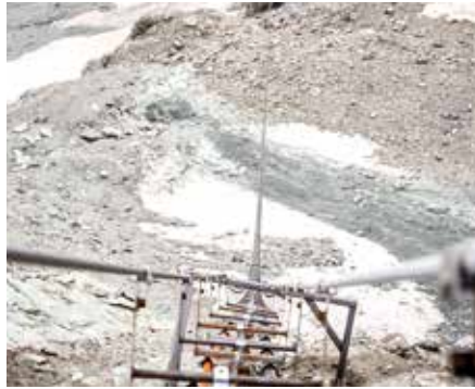
Der Blick nach unten entlang der Hängeleitung
