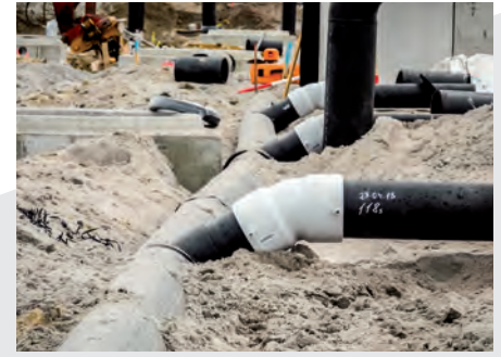
Homogen geschweißte PE-HD Leitung
